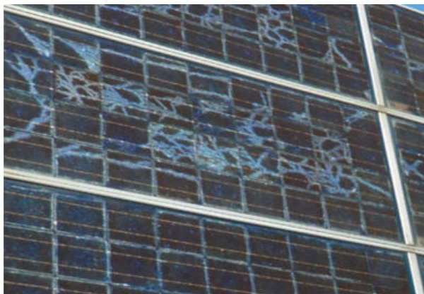
Obr. 4. Poškodenie FV panelu vplyvom priesaku vody do panelu ( http://www.airandwater.com.au )
